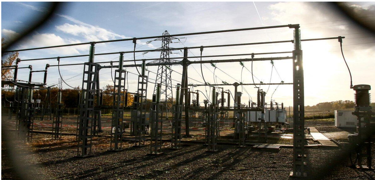
Un transformateur électrique haute tension du réseau RTE à Sémézies-Cachan, le 15 novembre 2023. © Photo Sébastien Lapeyrere / Hans Lucas via AFP
